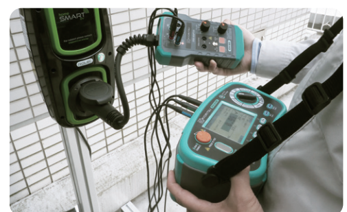
Foto de la prueba del punto de carga EVSE por EVSE ADAPTER y MFT
